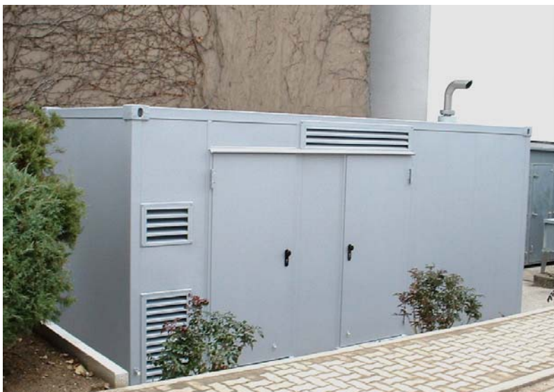
„Conpower“ komplette Lösung mit USV 40kW, NEA 150kVA + Klima
